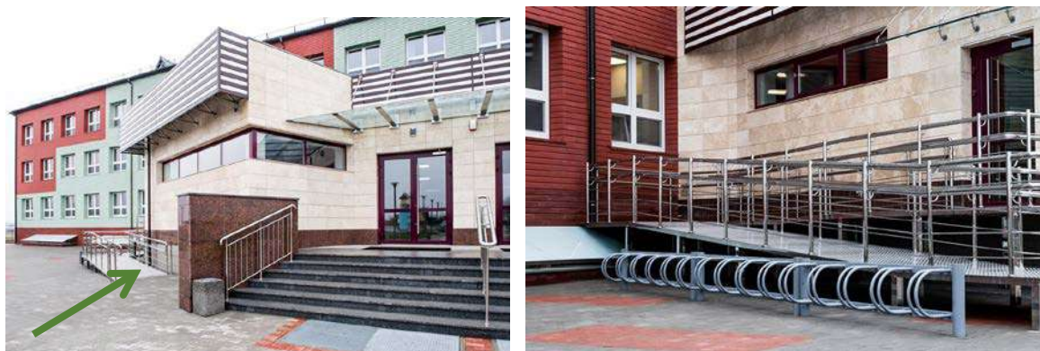
окремий вхід для маломобільних груп населення, біотехнологічний ліцей, с. Радово, Житомирська обл.
